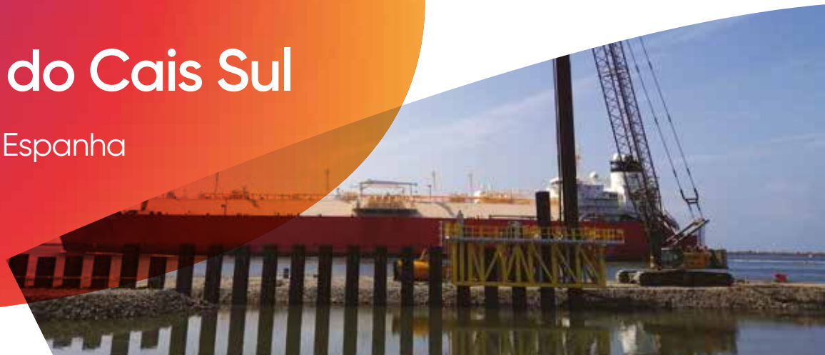
Extensão do Cais Sul | Instalação do sistema de cortina de estacas prancha combinada HZ ® -M/AZ ®
