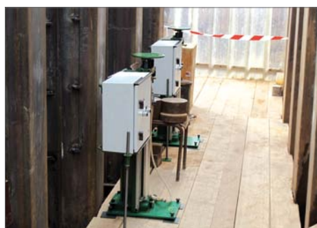
Instrumentation lors des essais in situ
