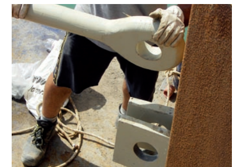
Ancrage revêtu de peinture
