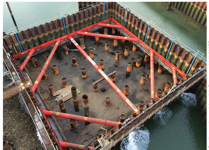
Barrière anti-crue à Ipswich, Royaume-Uni | ©MGF
