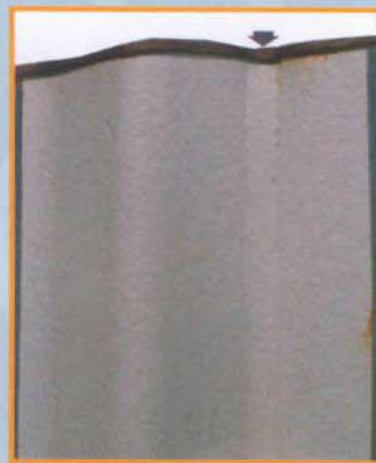
Aspect de la surface au niveau de la serrure des palplanches après un vieillissement accéléré.
