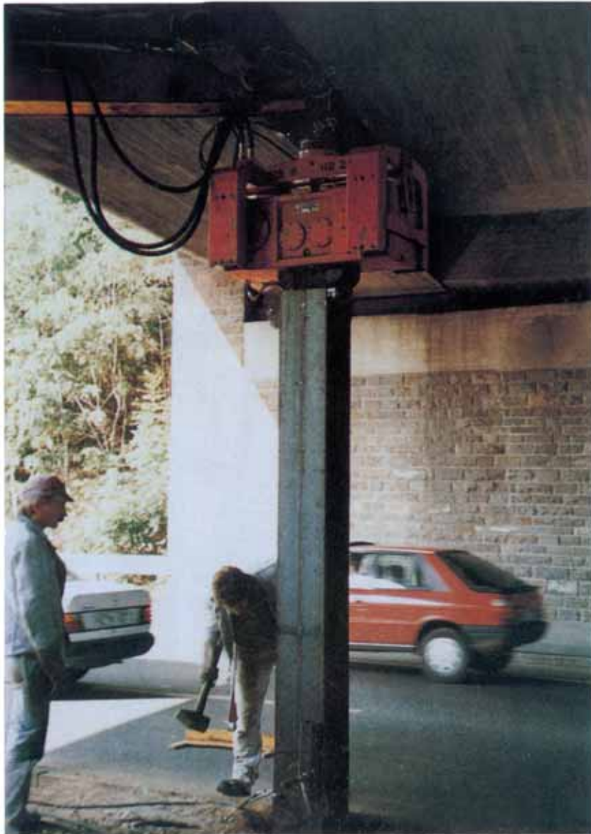
Figure 10.2-4: Si les conditions de sol le permettent, l'utilisation de vibrateurs fixés directement à la flèche d'une excavatrice peut constituer une solution intéressante.
